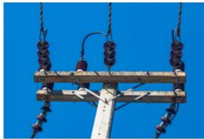
ง. ลูกถ้วยไฟฟ้า
