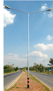
เสาไฟถนนสูง 6 ม. 50 ซม.
