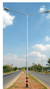
เสาไฟถนนสูง 6 ม. 50 ซม.
