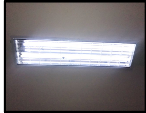
หลอดไฟฟ้า
