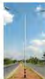
เสาไฟถนนสูง 6 ม. 50 ซม.
