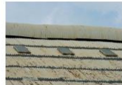
ภาพที่ 2 การผุกร่อนของหลังคาสังกะสีเมื่อทำปฏิกิริยากับฝนที่มีสมบัติเป็นกรด
