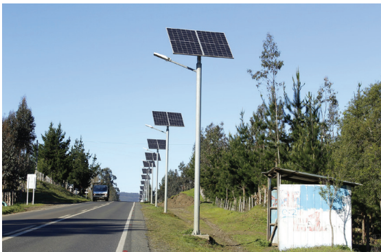
ค. เสาไฟถนน
