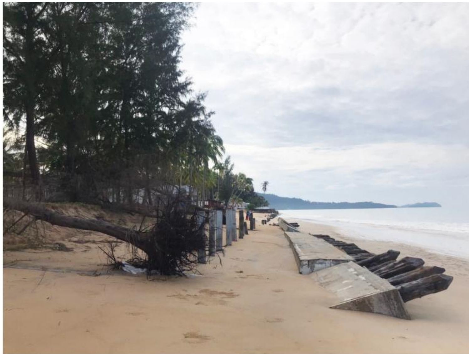
ภาพที่ 5 การกักเซาะชายฝั่ง หาดบางเนียง ตำบลคึกคัก อำเภอตะกั่วป่า จังหวัดพังงา ที่มา : กรมทรัพยากรทางทะเลและชายฝั่ง
