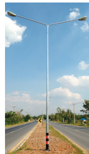
เสาไฟถนนสูง 6 ม. 50 ซม.
