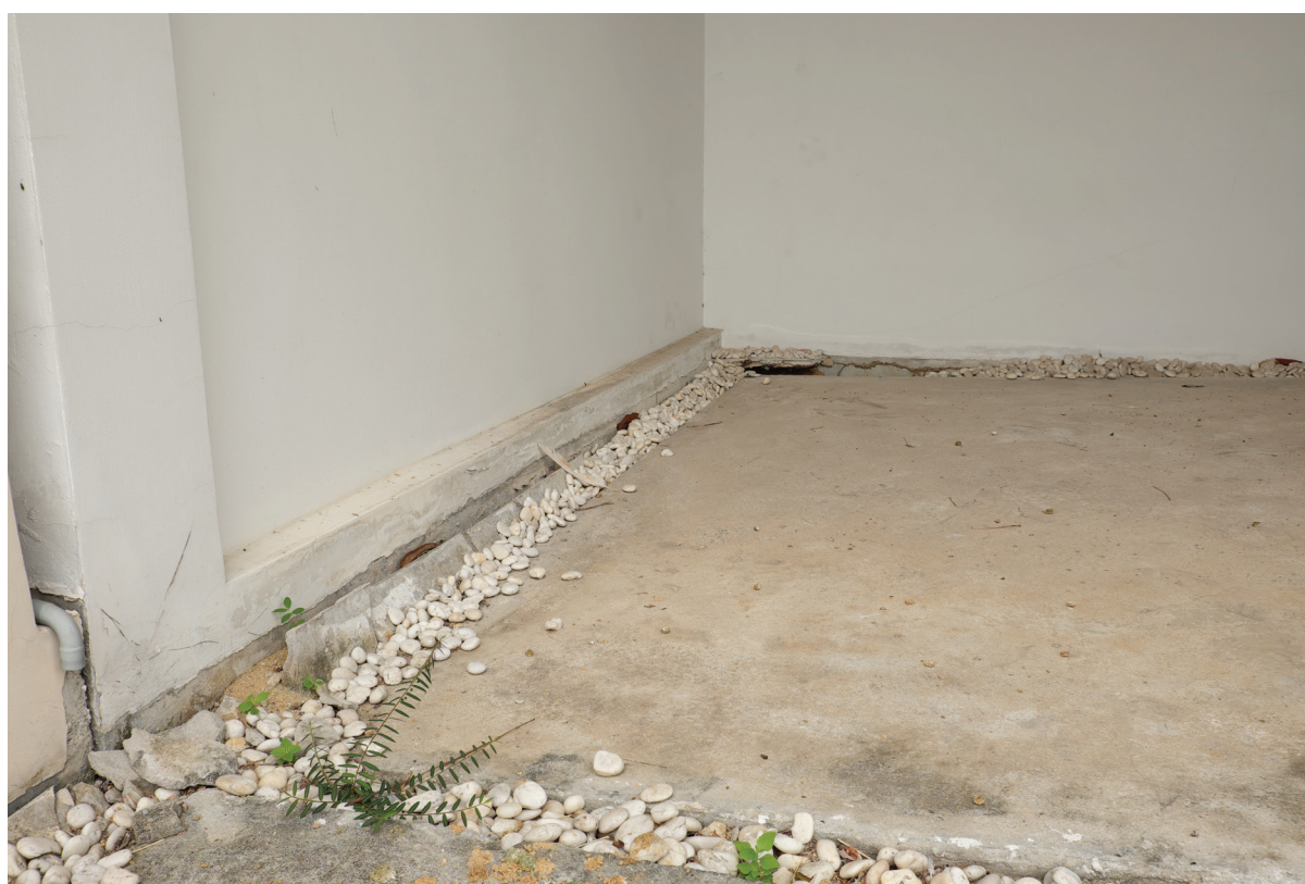
ภาพที่ 2 พื้นคอนกรีตทรุดตัวเนื่องจากแผ่นดินทรุด
