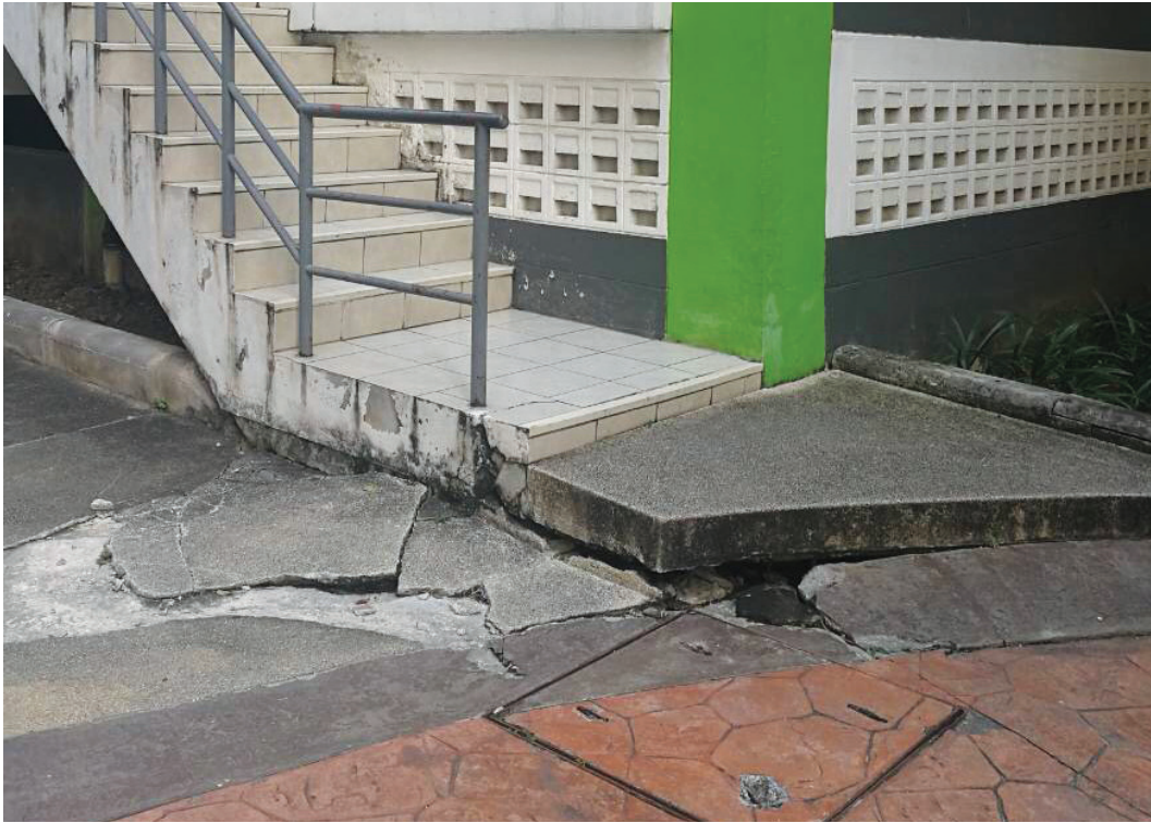
ภาพที่ 3 พื้นคอนกรีตหลุดตัวและแตกร้าวเนื่องจากแผ่นดินไหว
