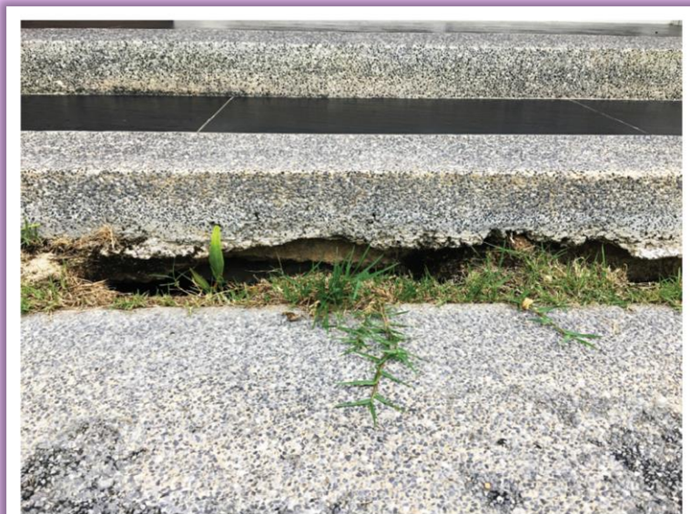
ข. พื้นอาคารทรุด แตกออกจากบันไดอาคาร ภาพที่ 1 แผ่นดินทรุด
