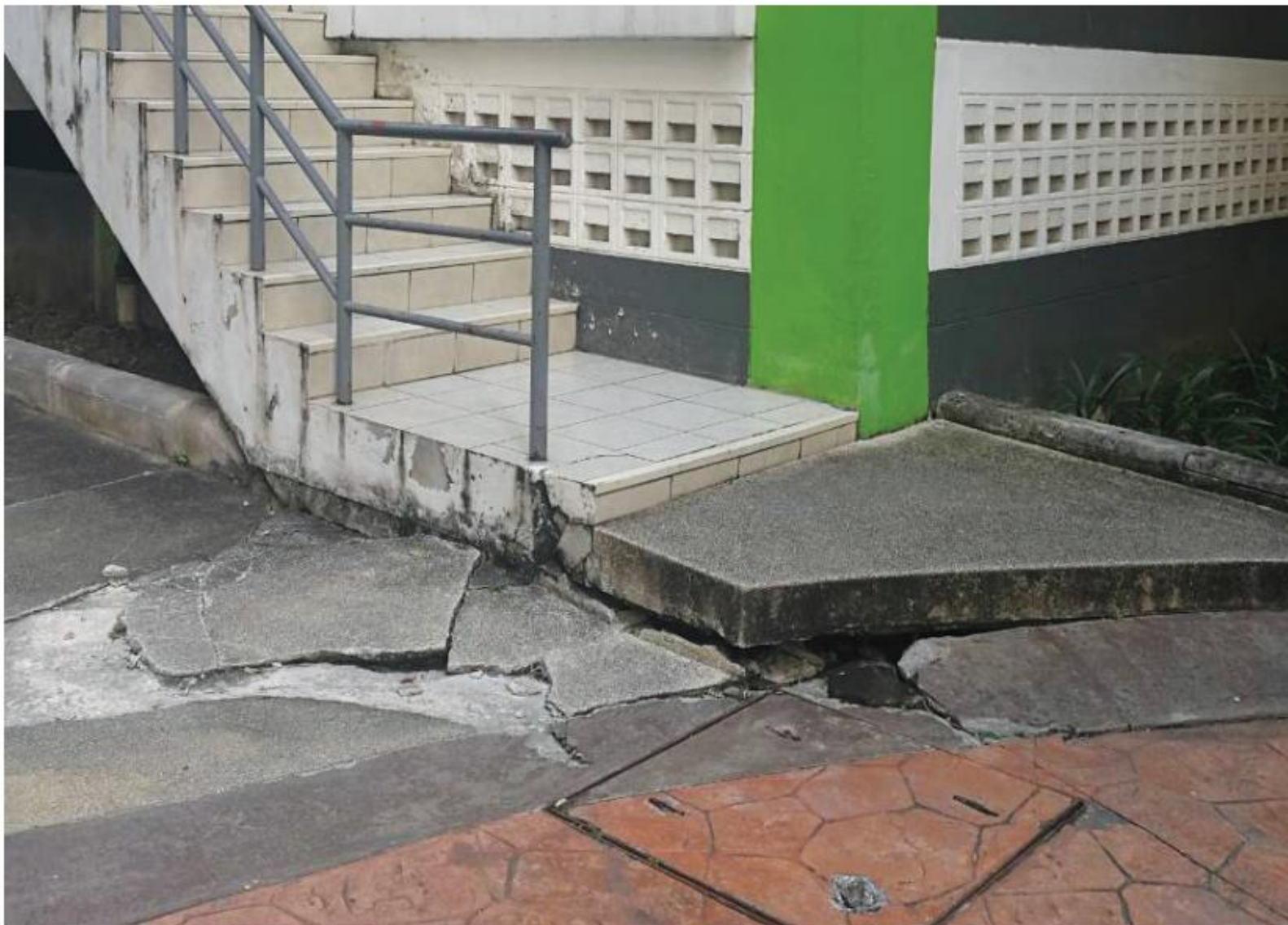
ภาพที่ 3 พื้นคอนกรีตทรุดตัวและแตกร้าวเนื่องจากแผ่นดินทรุด
