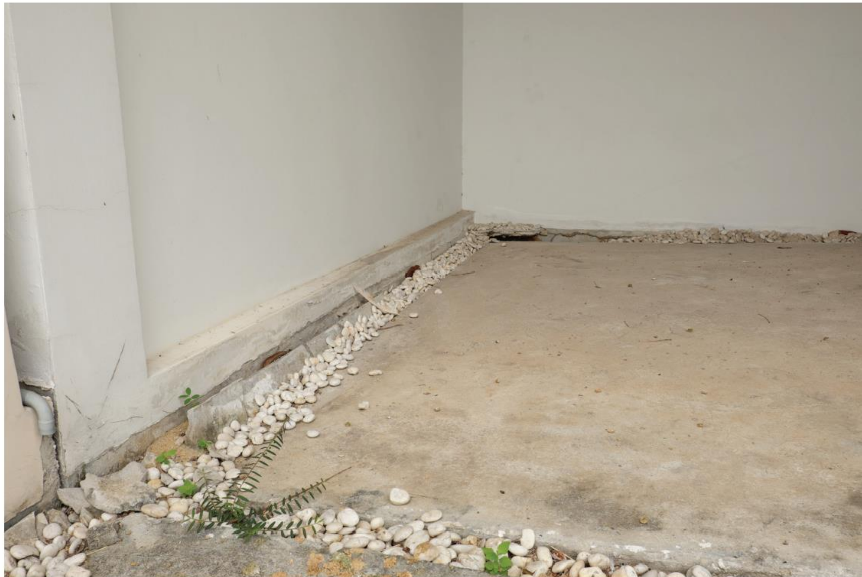
ภาพที่ 2 พื้นคอนกรีตทรุดตัวเนื่องจากแผ่นดินไหว
