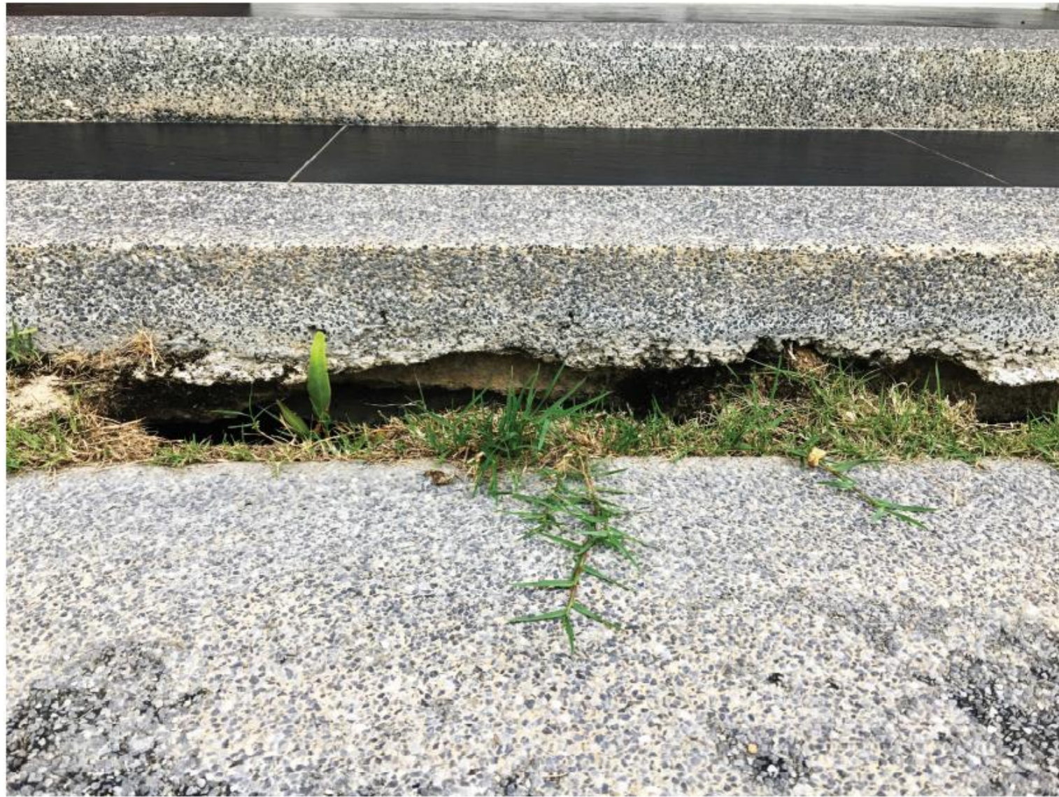
ข. พื้นอาคารทรุด แตกออกจากชั้นได้อาคาร ภาพที่ 1 แผ่นดินทรุด
