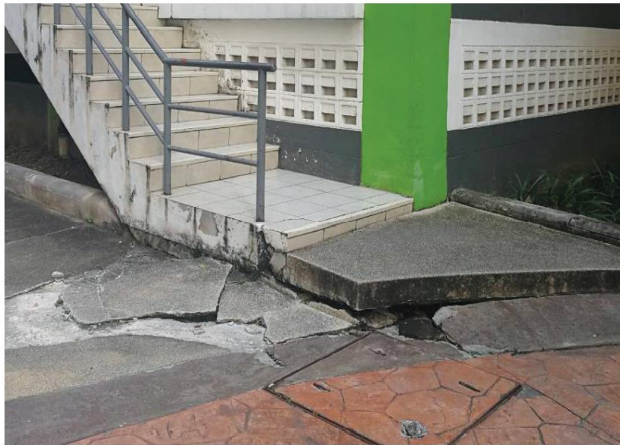
ภาพที่ 3 พื้นคอนกรีตทรุดตัวและแตกร้าวเนื่องจากแผ่นดินทรุด
