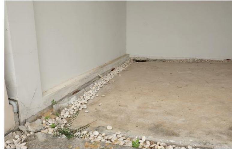
ภาพที่ 2 พื้นคอนกรีตทรุดตัวเนื่องจากแผ่นดินทรุด
