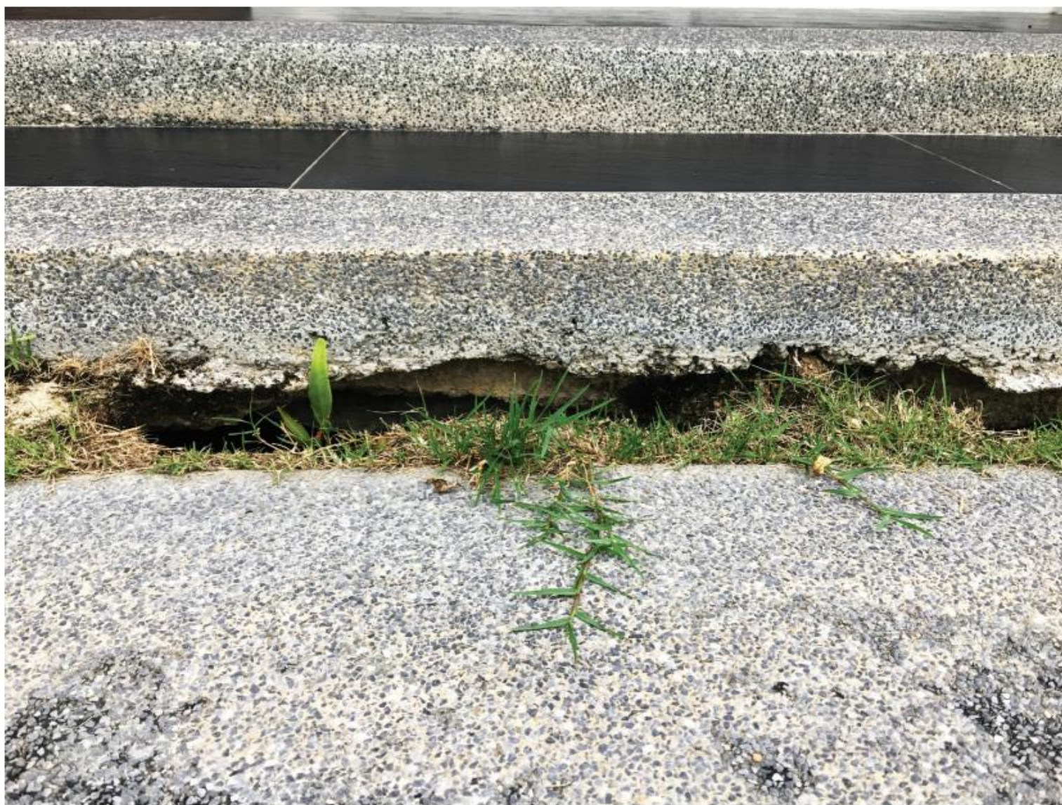
ข. พื้นอาคารทรุด แตกออกจากบันไดอาคาร ภาพที่ 1 แผ่นดินทรุด
