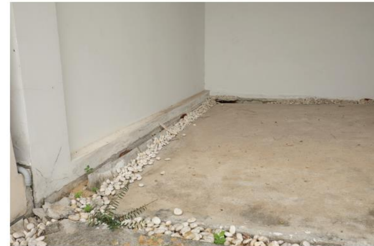
ภาพที่ 2 พื้นคอนกรีตทรุดตัวเนื่องจากแผ่นดินทรุด
