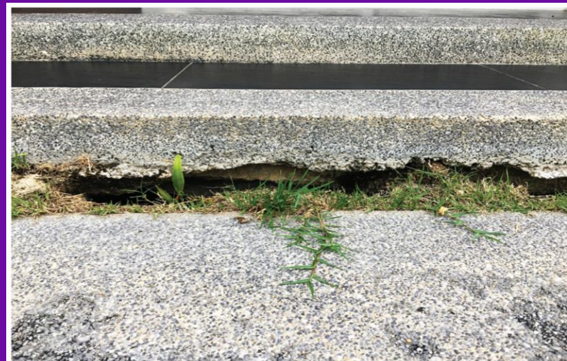
ข. พื้นอาคารทรุด แตกออกจากบันไดอาคาร ภาพที่ 1 แผ่นดินทรุด
